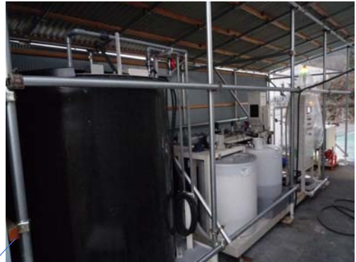
排水処理装置
